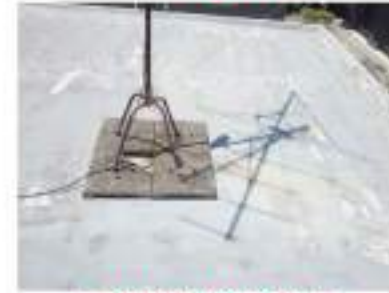
屋根防水の劣化
