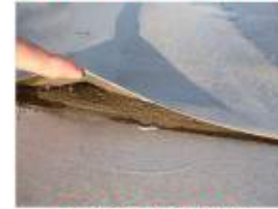
屋根防水の捲れ
