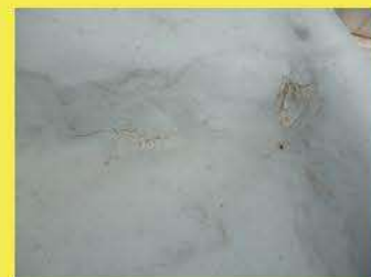
屋根防水の割れ
