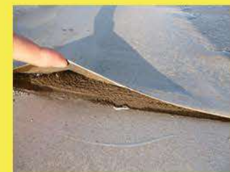
屋根防水の捲れ
