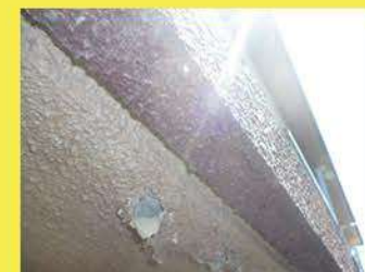
外壁塗装のひび割れ
