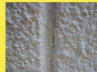
外壁目地部分のひび割れ
