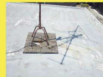
屋根防水の劣化
