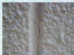
外壁目地部分のひび割れ
