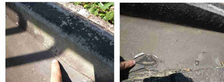
①防水層の膨れ
