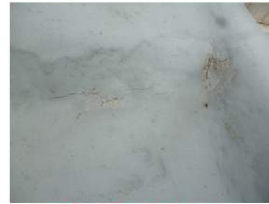
屋根防水の割れ
