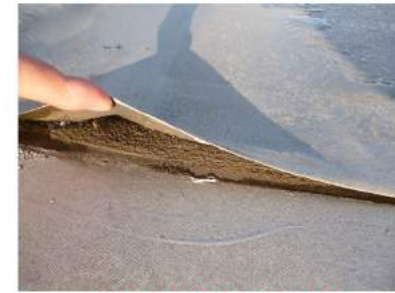
屋根防水の捲れ
