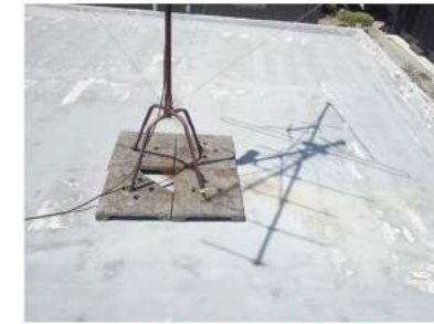
屋根防水の劣化
