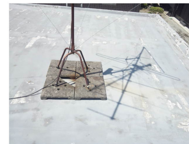
屋根防水の劣化
