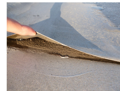
屋根防水の捲れ
