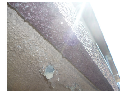
外壁の捲れ・ひび割れ
