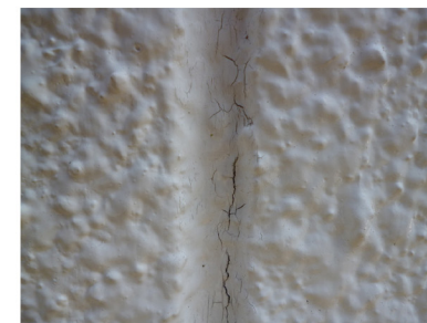
目地部分のひび割れ
