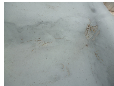
屋根防水の割れ
