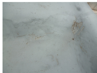
屋根防水の割れ
