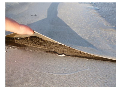
屋根防水の捲れ
