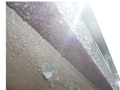
外壁塗装の捲れ
