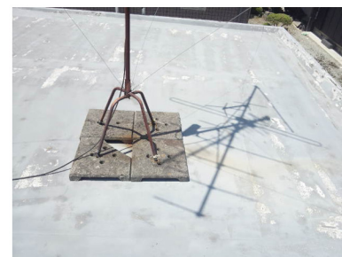
屋根防水の劣化
