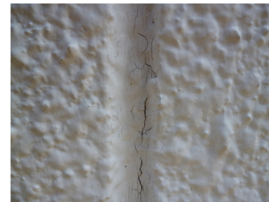
壁の目地部分のひび割れ
